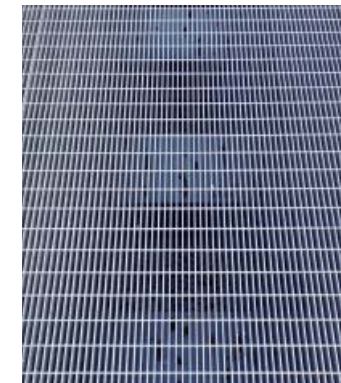
griglia di ventilazione dei parcheggi interrati
